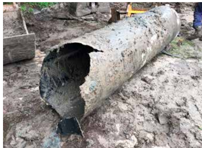
Figuur 5.1 Voorbeeld van een rondbreuk bij een GVK buis
